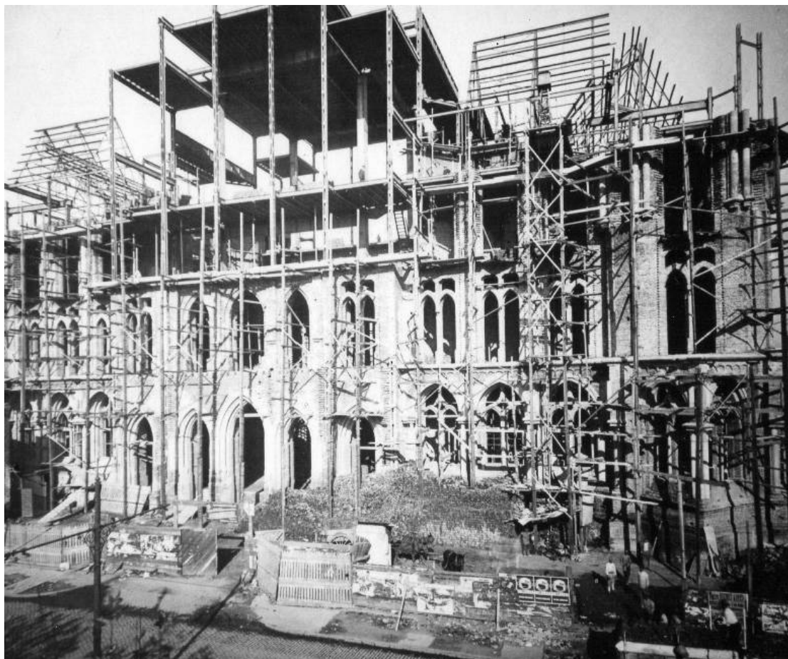
Fotos Ma. del Carmen Maza. Foto original en el Museo de Ciencia y Técnica de la Facultad de Ingeniería - UBA
